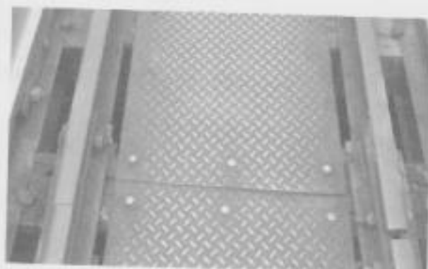
Giunto di dilatazione di una rotaia
